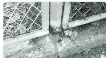
錆びたフェンス
